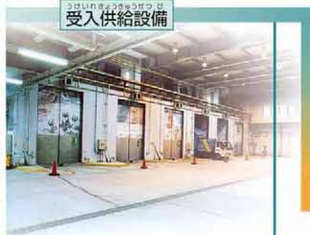
■プラットフォーム 搬入車でごみを投入する場所です。
