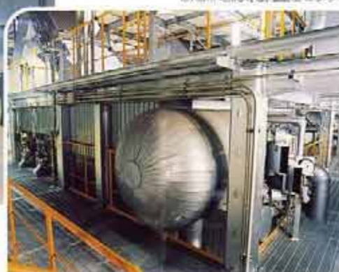
■ボイラ(外観) 焼却炉で発生する排ガスの温度を下げる的同时に、回収した熱で蒸気を発生させます。
