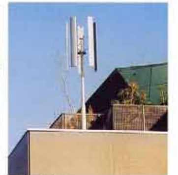
■風力発電装置
