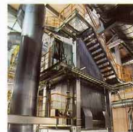
■触媒反応塔 排ガス中の窒素酸化物を除去します。
