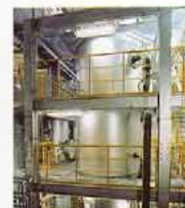
■湿式洗煙塔 排ガス中の有害物質を除去するため、水で洗浄します。
