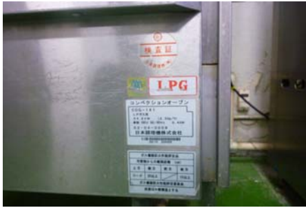
焼物機の下部。検査証等のシールが貼付されている。
