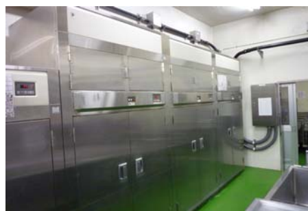
「学校給食備品台帳兼備品管理簿」に未記載の食器食缶消毒保管機
