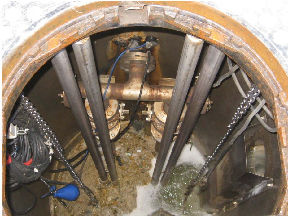
(マンホールポンプ)
