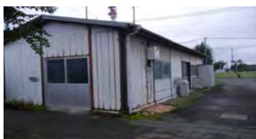
建物の老朽化（陶芸室）
