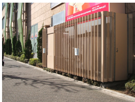
外壁と同色の囲いで設備が歩道にむき出しとならないよう、修景しています。(文京区)
