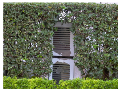
メーター類のまわりを緑化しています。(柏の葉一丁目)
