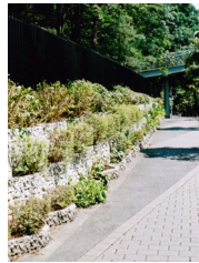
緑化擁壁を用いた修景。(光ヶ丘)
