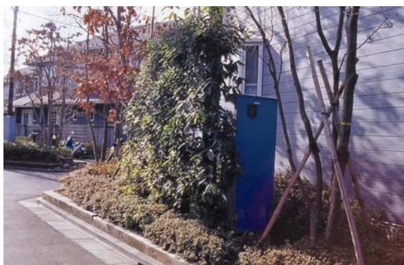
独立した設備類を樹木で修景している例
