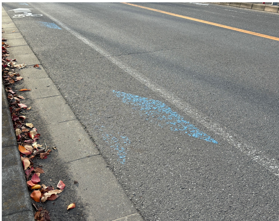
図 4-4 舗装が剥がれかけている矢羽根（新柏周辺）
