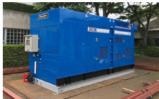
仮設発電機例
