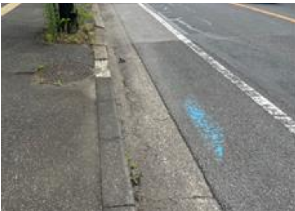
図 4-4 舗装が剥がれかけている矢羽根（新柏周辺）
