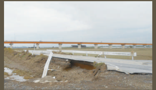
▲ガードレールや道路が破損(田中調節池内)
