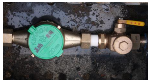
Interior de la caja del medidor
