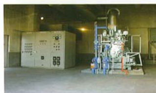
非常用発電設備
