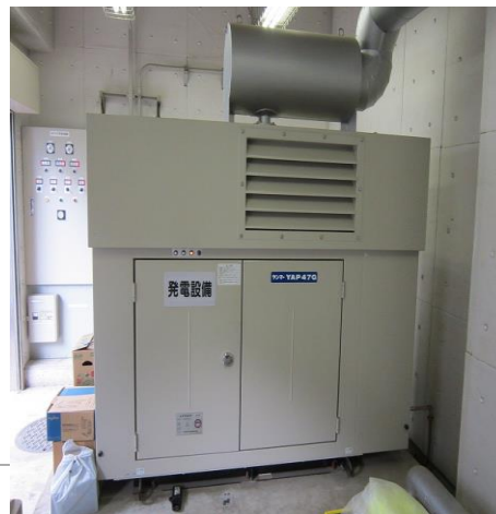
自家用発電機
