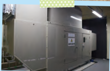
非常用発電機。災害時の拠点としての機能が維持できる。
