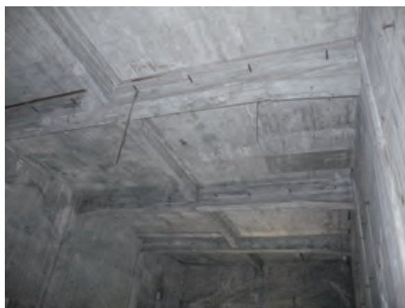
壁には表面仕上げがされておらず、コンクリート型枠を緊結した鉄棒が壁面から突出するままだに残る。鉄棒の一部に残る針金や縄の断片より、天井造作を設けずに映写幕を吊したことがうかがえる。
