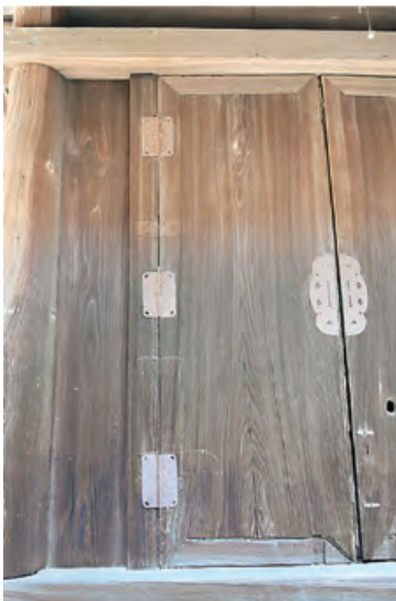
写真1 扉に残された痕跡全体像 <春日社>
