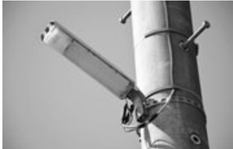
市内に設置されたLEDの防犯灯
