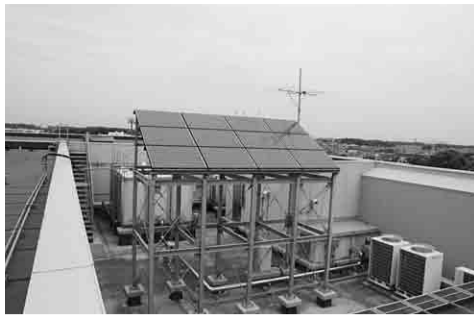
南部クリーンセンターの太陽光発電
