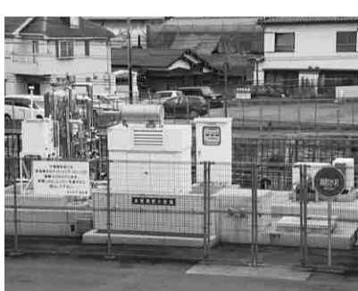
市役所にある非常用貯水装置
