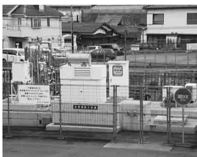
市役所にある非常用貯水装置
