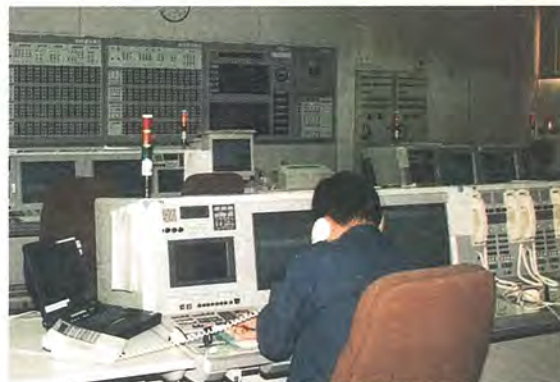
消防本部の隣に消防指令センターを開設(4月)
