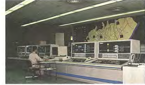
すべての水源地をコントロールする中央管理室
