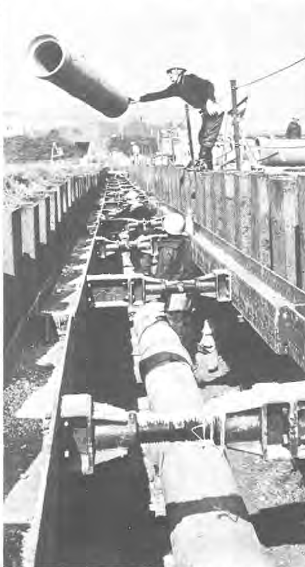
下水道工事は、着実に進んでいます(柏下の汚水幹線工事 11月23日撮影)
