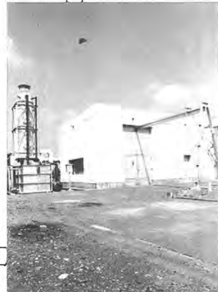
▲地下水に塩素を注入し消毒をする塩素注入装置です
