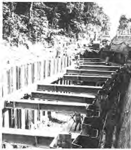
快適な生活環境を目指して建設が進む公共下水道工事
