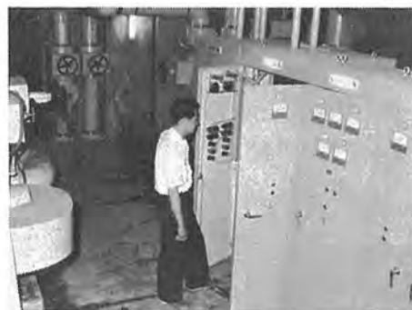
会館の心臓部ともいえる機械操作室。ここでは暖冷房や電気などの操作がなされます
