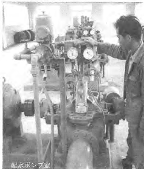
▼ ポンプ室では、遠い所や高い所でも水道が勢よく出るように、圧力を加えるとともに本管へ送水します。
