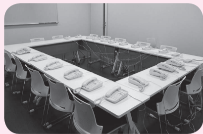
▲万が一に備え、コールセンター用の電話設備とスペースを確保
