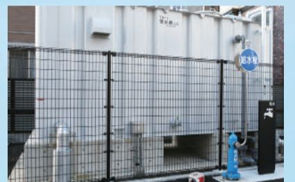
▲水道部庁舎にある受水槽
