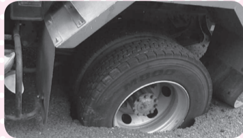
▲道路陥没は事故やけがにつながり危険
