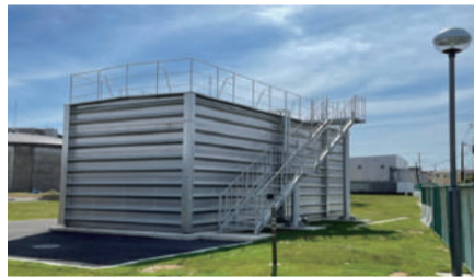
▲くみ上げた地下水が集まる着水井(ちゃくすいせい)
