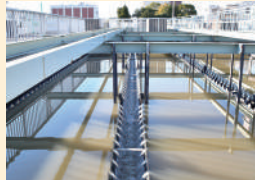
まだ汚く濁っている水
