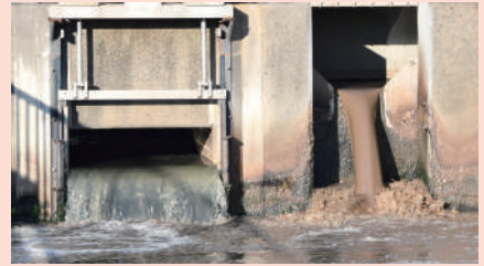
汚水(左)と活性汚泥
