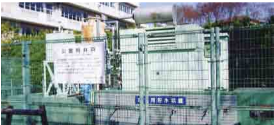
耐震性井戸付貯水装置 (災害用井戸)
