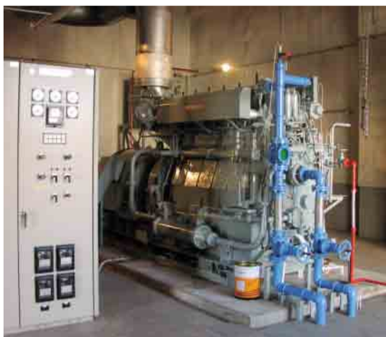
非常用発電設備
