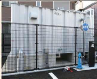
▲上下水道局庁舎にある受水槽
